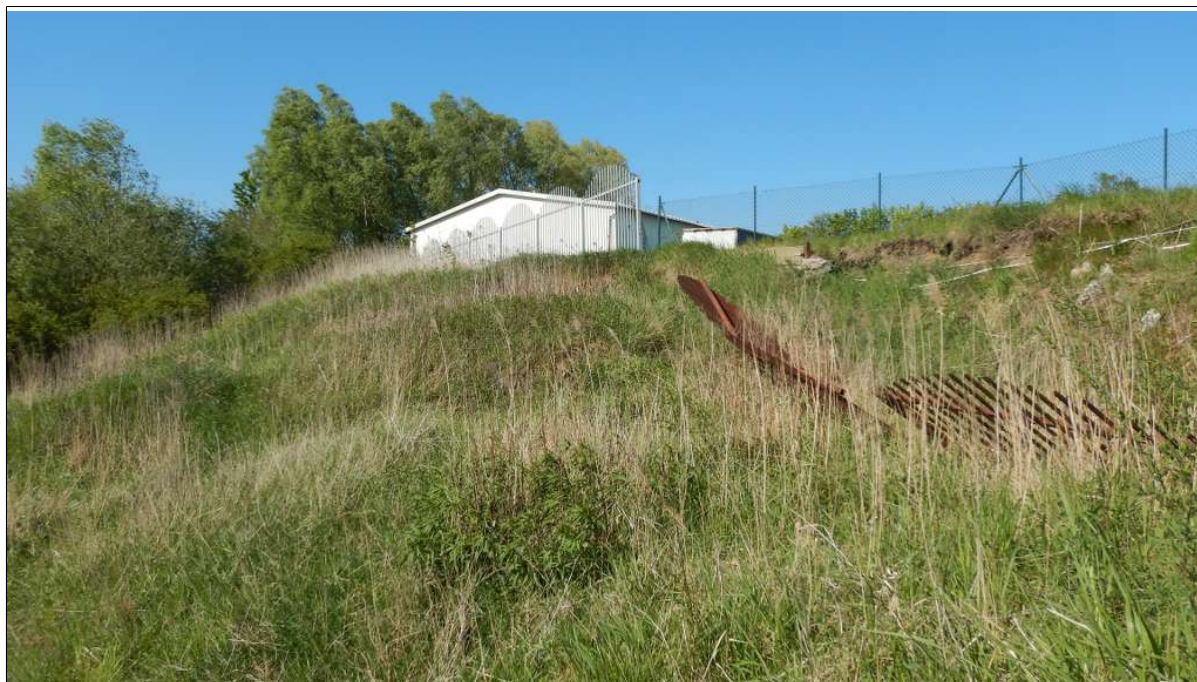
Koluwium aktywnego osuwiska z przemieszczonym fragmentem metalowego ogrodzenia
