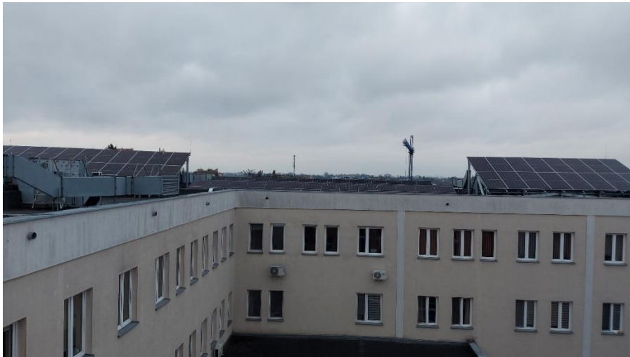
Fot. Widok paneli fotowoltaicznych na dachu.
